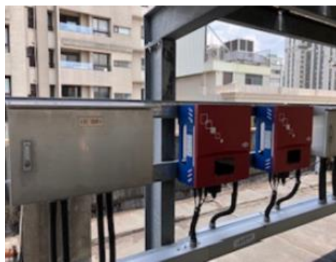
天空5號發電設備
