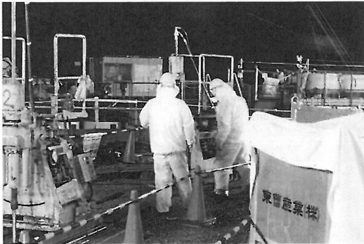
事故後，福島第一核電廠內的作業情形。 攝於 2013 年 7 月。《福島十大教訓》提供
